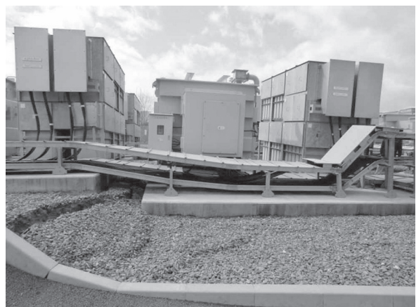
（写真5）3GeVシンクロトロン変圧器等の沈下状況
