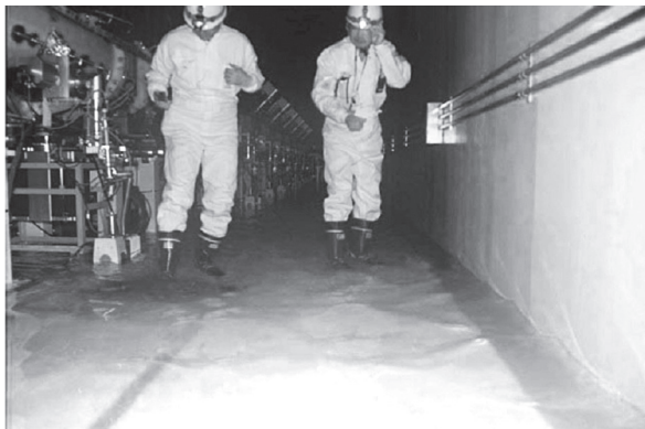
（写真4）リニアックトンネルの浸水状況
