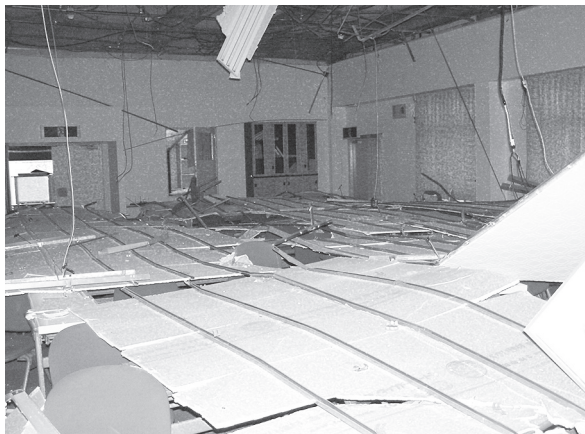
(写真 1) 落下した会議室の天井
